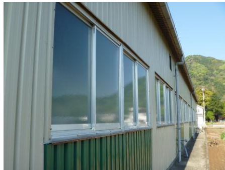
<耐寒対策後の工場北側外壁・窓枠>
