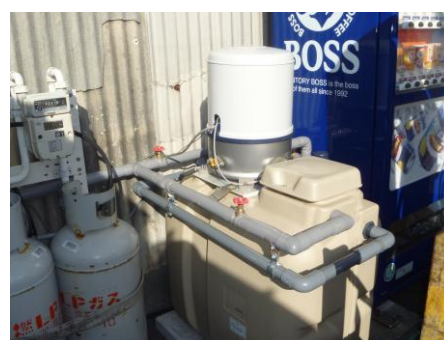
<2F専用冷却水循環ポンプ>
